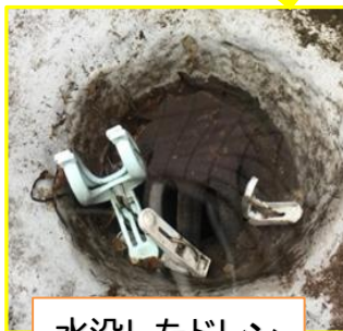
水没したドレン
