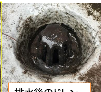
排水後のドレン
