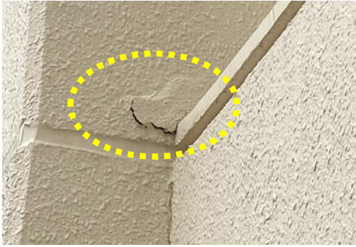
ベランダ側上部モルタル亀裂
