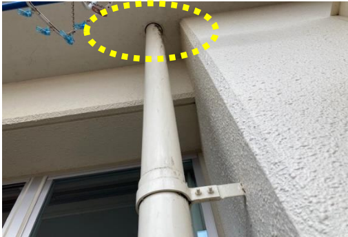
雨水管とルーフドレンとの隙間から漏水
