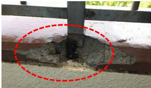
コ ン ク リ ー ト 剥 離
