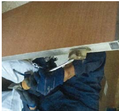
自動扉下側の異物除去
