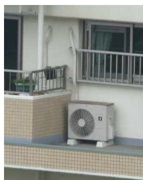
庇の上（開放廊下の上）への室外機の設置（例）
